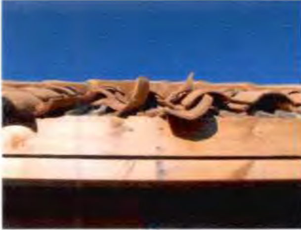
Fotografía N° 20: Detalle del estado de la cubierta de las garitas del recinto.
