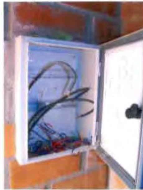
Fotografía N° 21: Detalle del estado tablero eléctrico del recinto sin los componentes.
